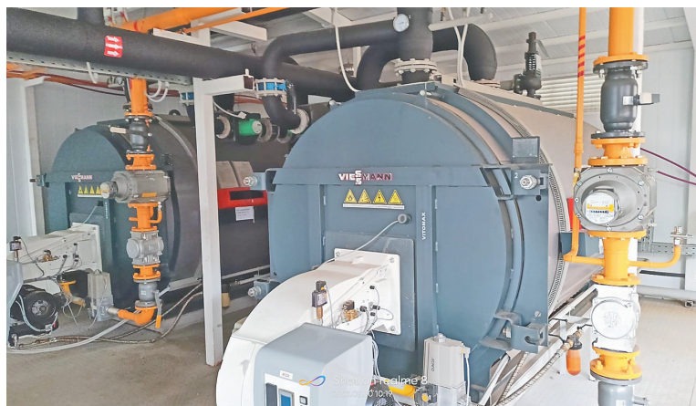
Котельная в Курбе к отопительному сезону готова
